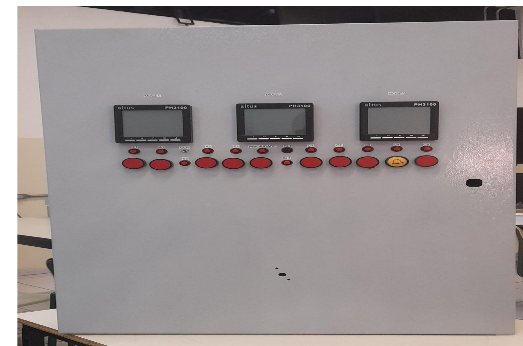
Figura 3 - Painel de comando
