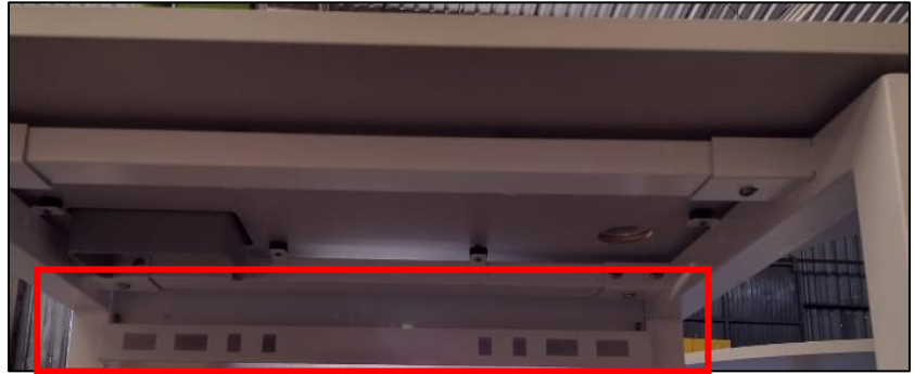
Figura 2-Leito para fiação e tampa lateral visto por dentro
