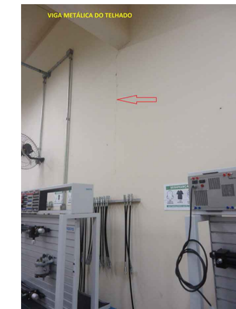
FOTO 10 - FISSURA JUNTO À VIGA METÁLICA DO TELHADO
