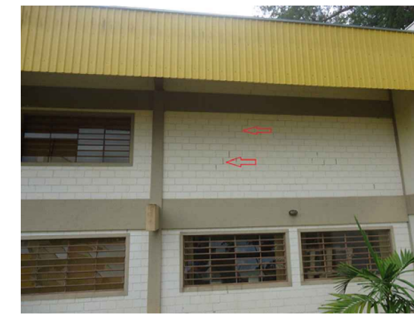
FOTO 7 - FISSURA EXTERNA NA PAREDE DO LABORATÓRIO DE INFORMÁTICA
