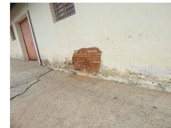
FOTO 12- DECOMPOSIÇÃO DA ARGAMASSA DE REVESTIMENTO EXTERNO
