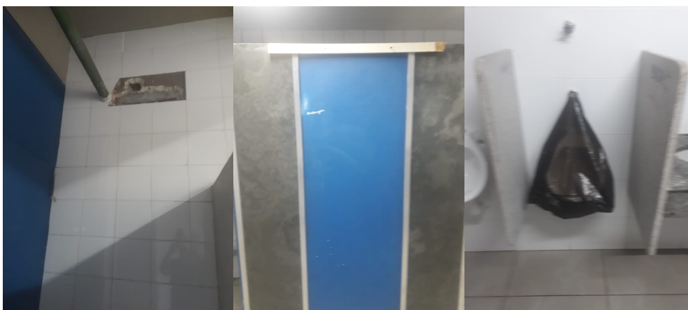
Banheiros interditados por vazamentos ou válvulas quebradas.
