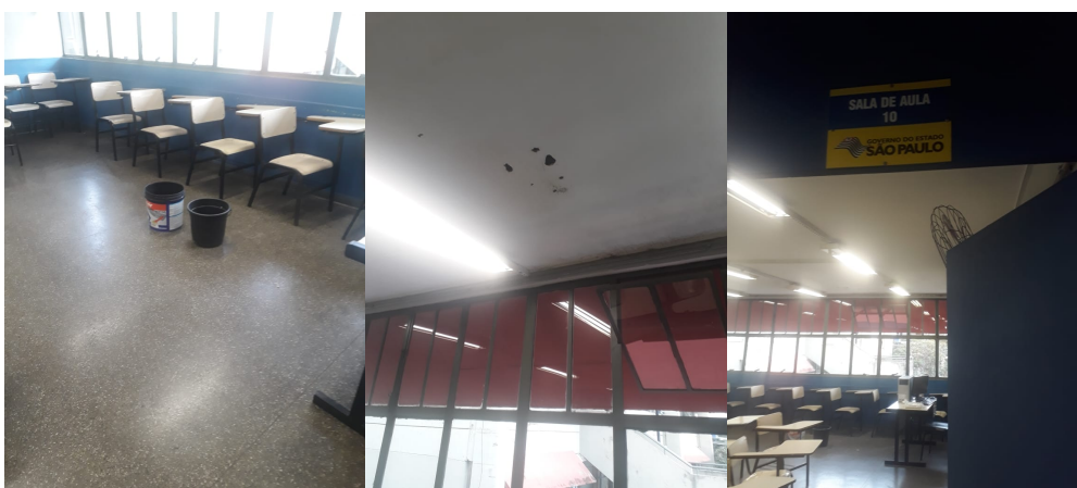
Salas de aulas interditada por infiltração no telhado.
