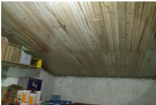
(a) Teto de madeira e matéria-prima armazenada de forma inadequada.
