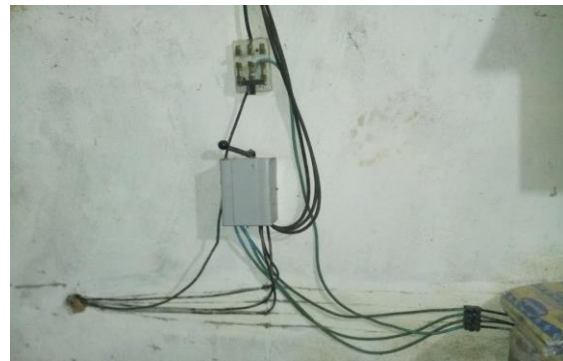
(b) Fiação elétrica exposta.
